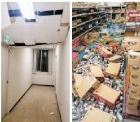
常温商品の物流拠点となっている倉庫の物品落下・天井崩落
